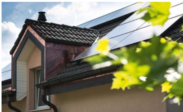
Détail des panneaux solaires en toiture.
