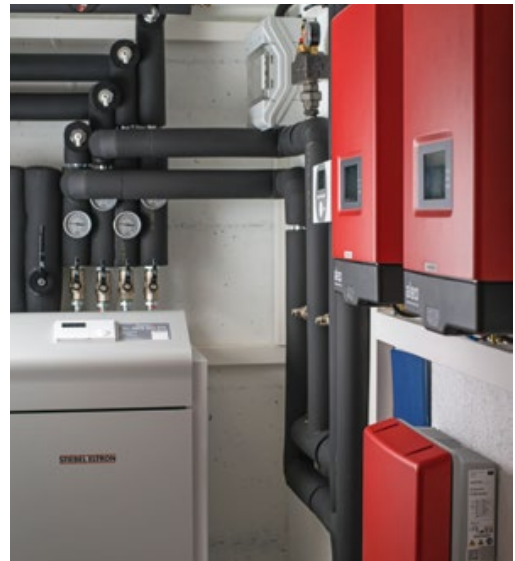
Le local technique avec la pompe à chaleur.
