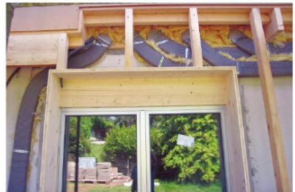
Photo 2.34 Le passage des gaines de ventilation dans l'ossature bois fixées sur la façade existante avant l'isolation par l'extérieur (ouate de cellulose)
